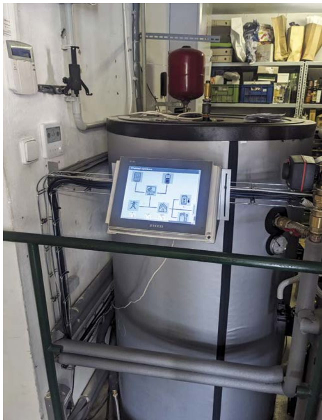
Akumulační nádoba napojená na bojler a systém Control4Energy. Ten řídí dům tak, aby do sebe ukládal energii ve správných momentech.
